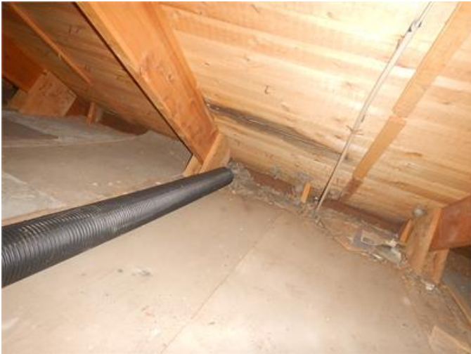
Fuktpåverkan på underlagstak vind.
