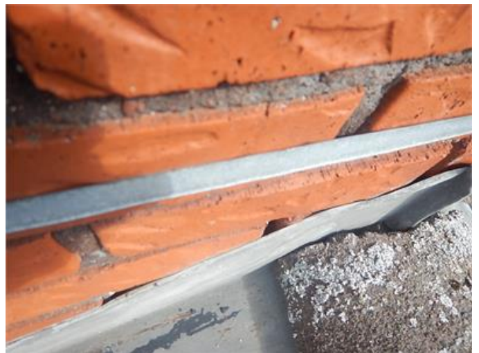
Otätthet mellan murstock och skorstensbeslag.
