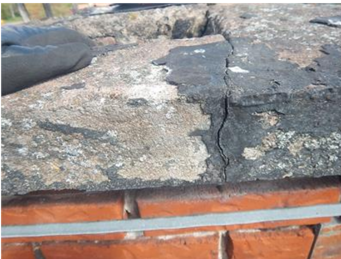
Överdel på skorstenen som är sprucken.
