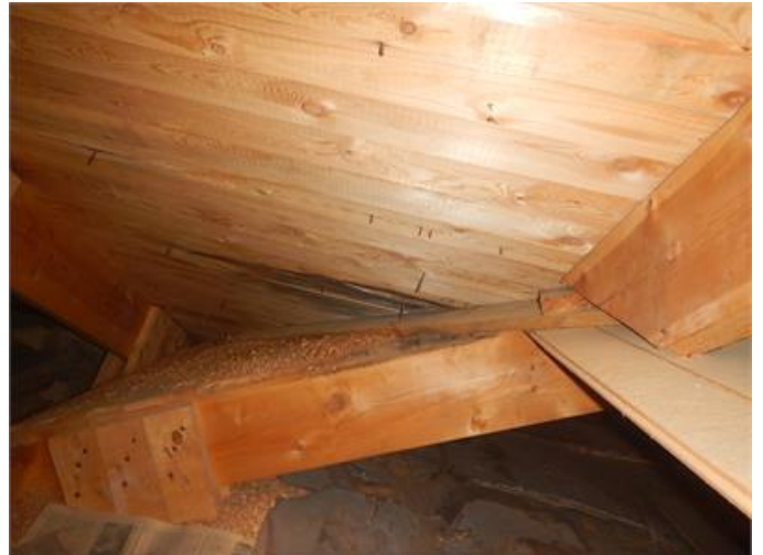
Fuktpåverkan på underlagstak vind.
